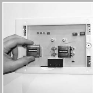
Batterien tauschen und Frontplatte wieder montieren.
